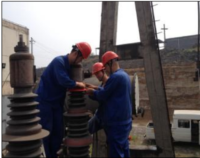
近日,水电分厂组织专业力量对水泥变110KV1号主变进行大型综合检修,内容包括主变的压力释放阀更换、变压器预防性试验、变压器高压套管的防雨罩安装及套管瓷瓶清洗等工作,提高主体设备的完好率。图为主变检修现场。摄影报道 张云珍
