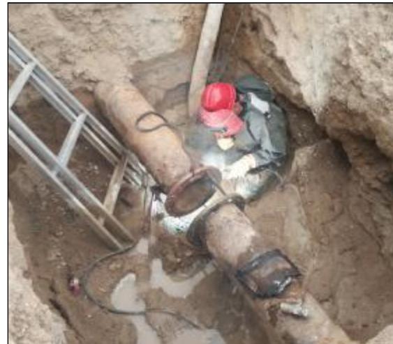
近日,水电分厂二车间组织实施生产补水管改造,经过6小时的奋战,成功将生产补水管和热化学车间反洗水管道分解成两条管网,避免了两端用户供水时相互影响,优化了补水系统,减轻了运行员工的操作强度。图为施工现场。摄影报道 薛秋云
